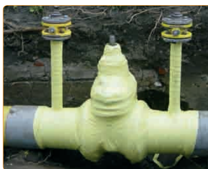
Przykład zaizolowanej zasuwy i połączeń kotnierzowych
