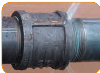
Wyciek na połączeniu gwintowanym
